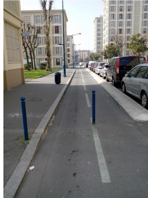
Potelet potentiellement dangereux
