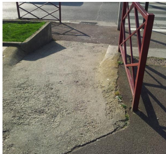
Revêtement en mauvais état et obstacles pour les malvoyants
